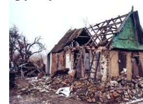
❖ Зруйновані будівлі та споруди
